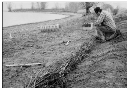
Les fagots sont déposés dans une tranchée et fixés au sol à l'aide de tiges métalliques.
